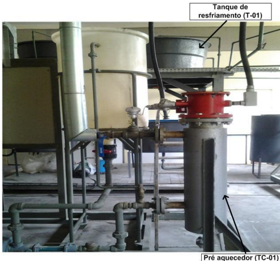
Figura 3 9 Seção de pré-aquecimento da Unidade de Craqueamento Piloto.
