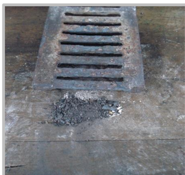
Figura 4.38 - Grelha deteriorada com escamações.
