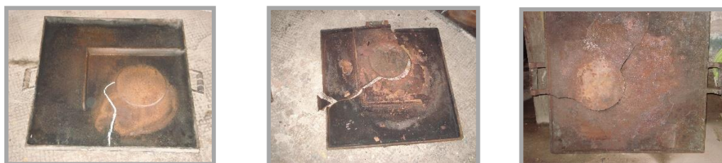
Figura 4.26 - Trincas ocorridas em placas com uso prolongado.
