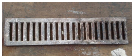
Figura 3.9 - Grelha degradada e deformada pelo calor.
