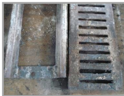
Figura 4.25 - Grelhas desgastados pela oxidação.
