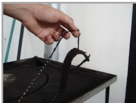
Figura 4.23 - Fita de vedação deteriorada.
