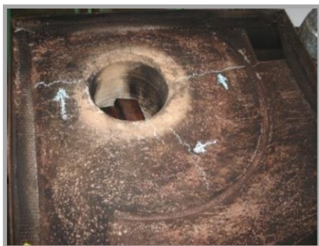
Figura 4.22 - Trincas no bloco cerâmicos e na câmara de combustão.
