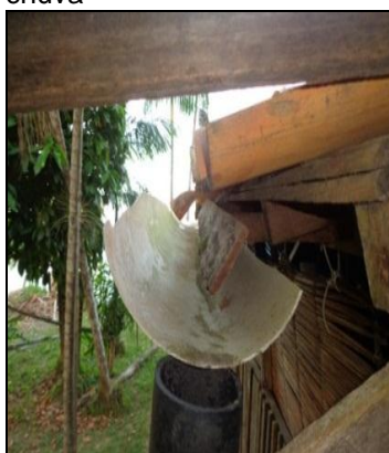
Foto 21 - Calha de captação da água da chuva
