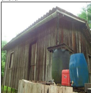
Foto 11 – Detalhe da calha lateral de captação da água da chuva
