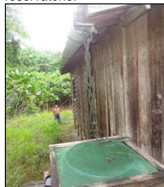
Foto 13 – Corda improvisada para conduzir a água para reservatório.
