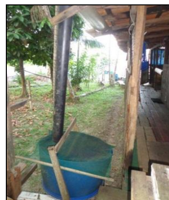
Foto 22 – Tubulação com tela de proteção
