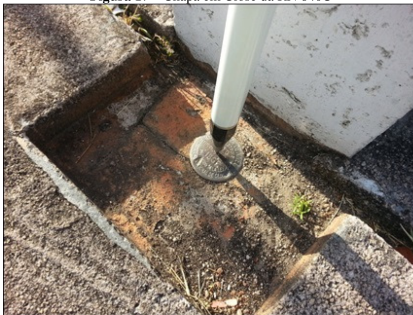
Figura 17 – Chapa em Close da RN 840U
