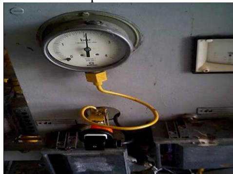
Figura 3.13 Local da instalação do transmissor de pressão.
