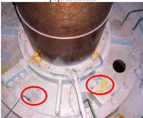
Figura 3.5 Sensor de referência instalado no poço da turbina.
