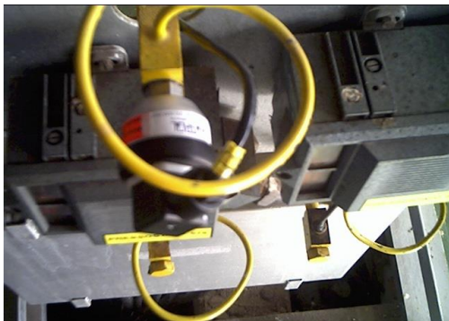
Figura 3.12 Transmissor de pressão instalado.
