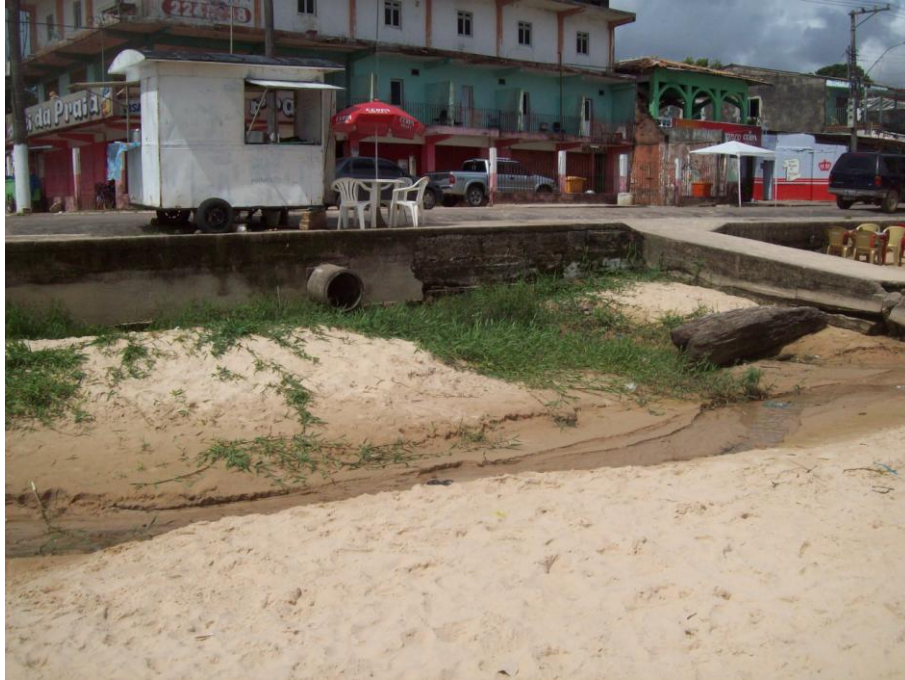
Fotografia 4 - Lançamento direto de esgoto doméstico na faixa da praia Grande associado ao sistema de manejo de águas pluviais, Ilha de Caratateua Fonte: Pesquisa de campo (2012)
