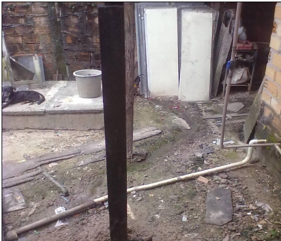
Fotografia 3 – Situação de precariedade do esgotamento doméstico em residência no Bairro São João de Outeiro, ilha de Caratateua. Fonte: Pesquisa de campo (2010)
