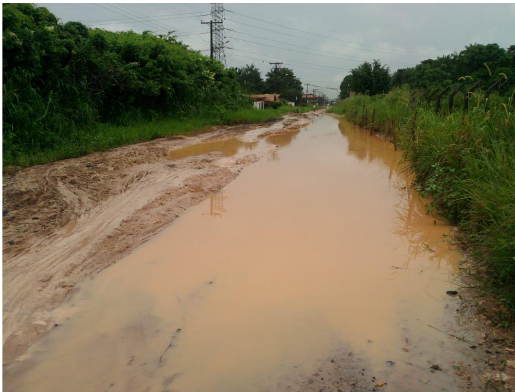
FOTO 05 - CONDIÇÕES DA ESTRADA DO AURÁ: trecho intrafegável na estrada do Aurá. Foto: José Luiz Sirotheau (04/02/2012).
