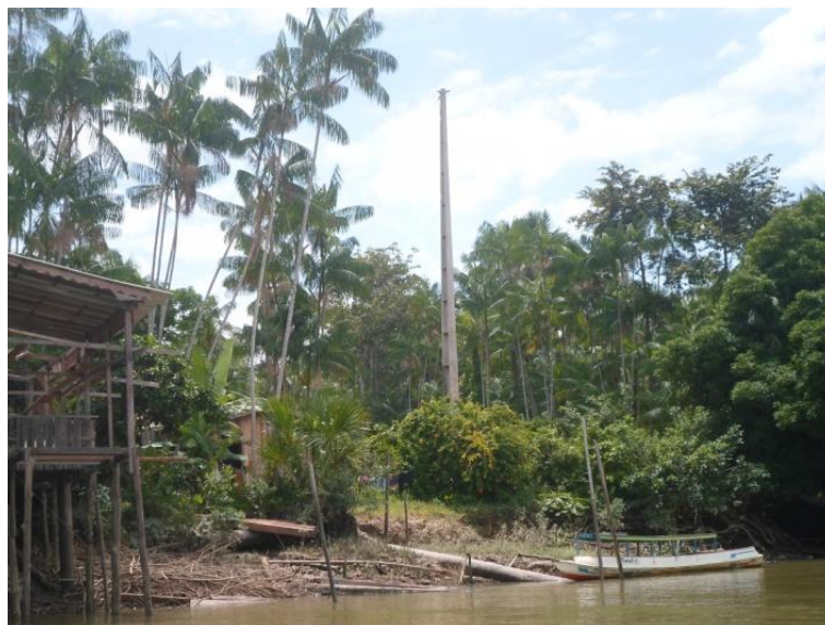
Figura 25: Poste de transmissão de energia elétrica no rio Sirituba (fevereiro de 2013)
