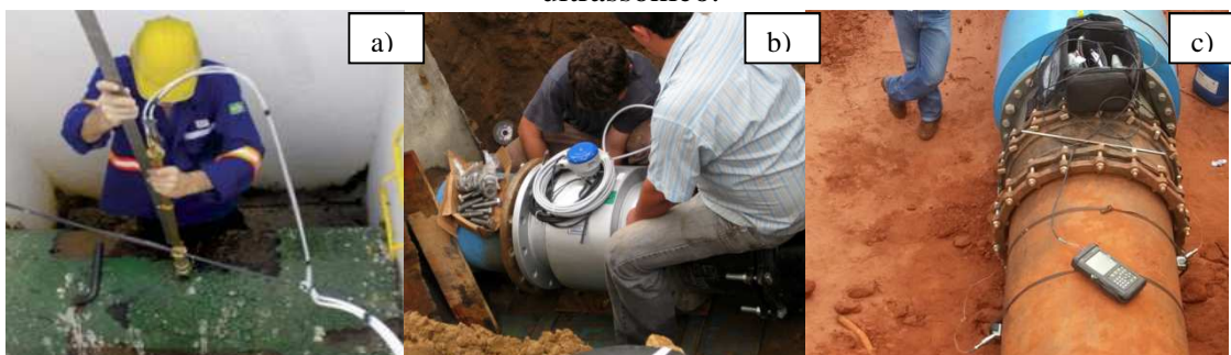
Figura 11: a) estações pitométrica, b) medidor eletromagnético e c) medidor ultrassônico.
