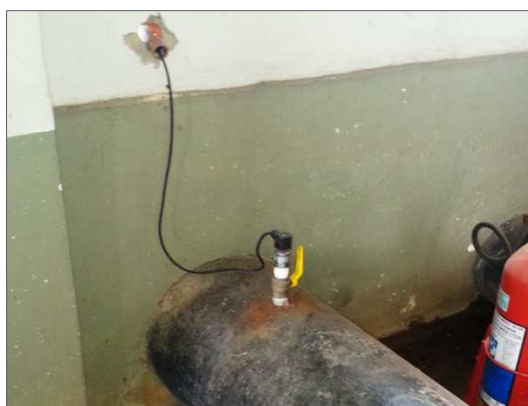
Fotografia 23: PD na tubulação de descida do REL para RDA e após registro.
