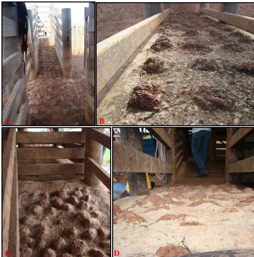
Figura 3 - Defeitos nas instalações que podem causar traumatismos nos dígitos de bovinos: A) Rampa de embarcador com piso calçado com pedras pontiagudas; B) detalhe da foto anterior; C e D) Rampas de acesso às balanças apresentando pisos irregulares, de concreto e pedra.
