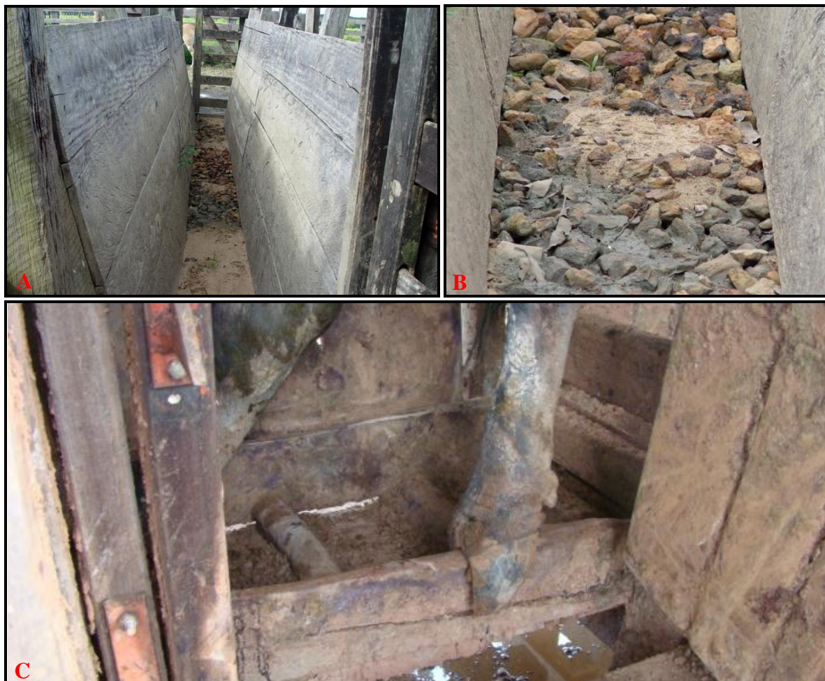
Figura 2 - Defeitos nas instalações que podem causar traumatismos nos dígitos de bovinos: A) Piso da seringa calçado com pedras; B) Detalhe da foto anterior; C) Troncos de contenção com tábuas laterais com quinas salientes.
