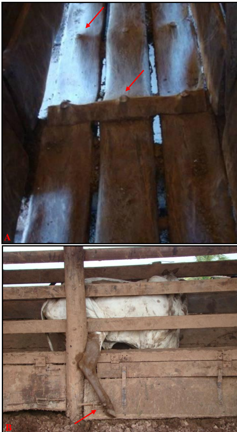
Figura 4 - Falta de manutenção e erros estruturais das instalações: A) Piso do tronco de contenção com travas antiderrapantes desgastadas com exposição de ferragens (setas); B) Aberturas laterais nas seringas, o que permite que o animal exponha os dígitos e sobreunhas às ferragens, favorecendo traumatismos (seta).
