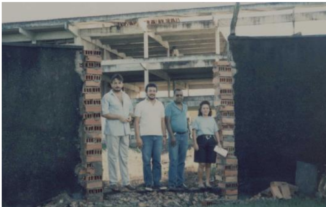
Figura 2: Retirada do muro que separava os prédios do 1º e 2º grau. Fonte: Arquivo pessoal do professor José Augusto Nunes Fernandez.
