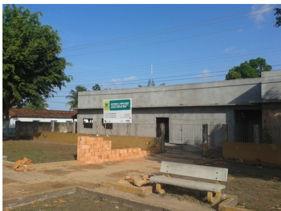
Figura 84: Reforma e Ampliação do Centro de Saúde Carlos Barreto, em Morada Nova Fonte: Acervo do autor, agosto de 2014
