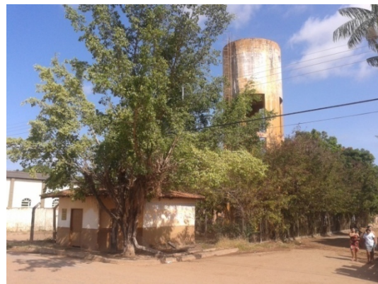
Figura 43: Reservatório do Sistema de Abastecimento de Água do São Félix I e II, no bairro São Félix II Fonte: Acervo do autor, agosto de 2014
