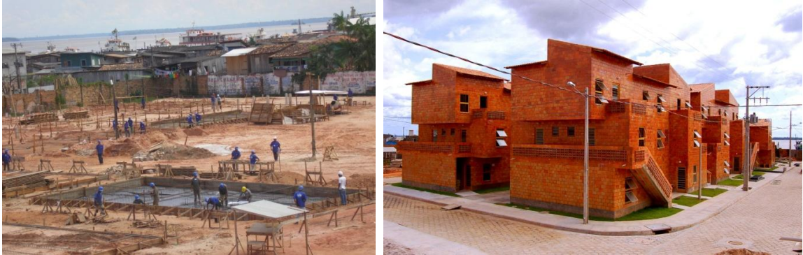
Fotografias 10 e 11 - Obra em construção e obra concluída da 1ª etapa do projeto Vila da Barca.
