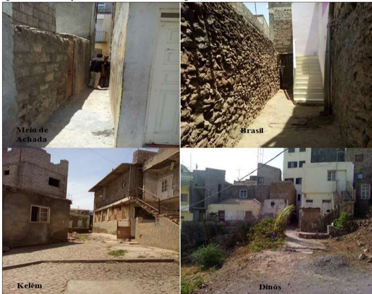
Figura 11: Estruturas precárias dos assentamentos em alguns territórios do bairro de Achada Santo António.
