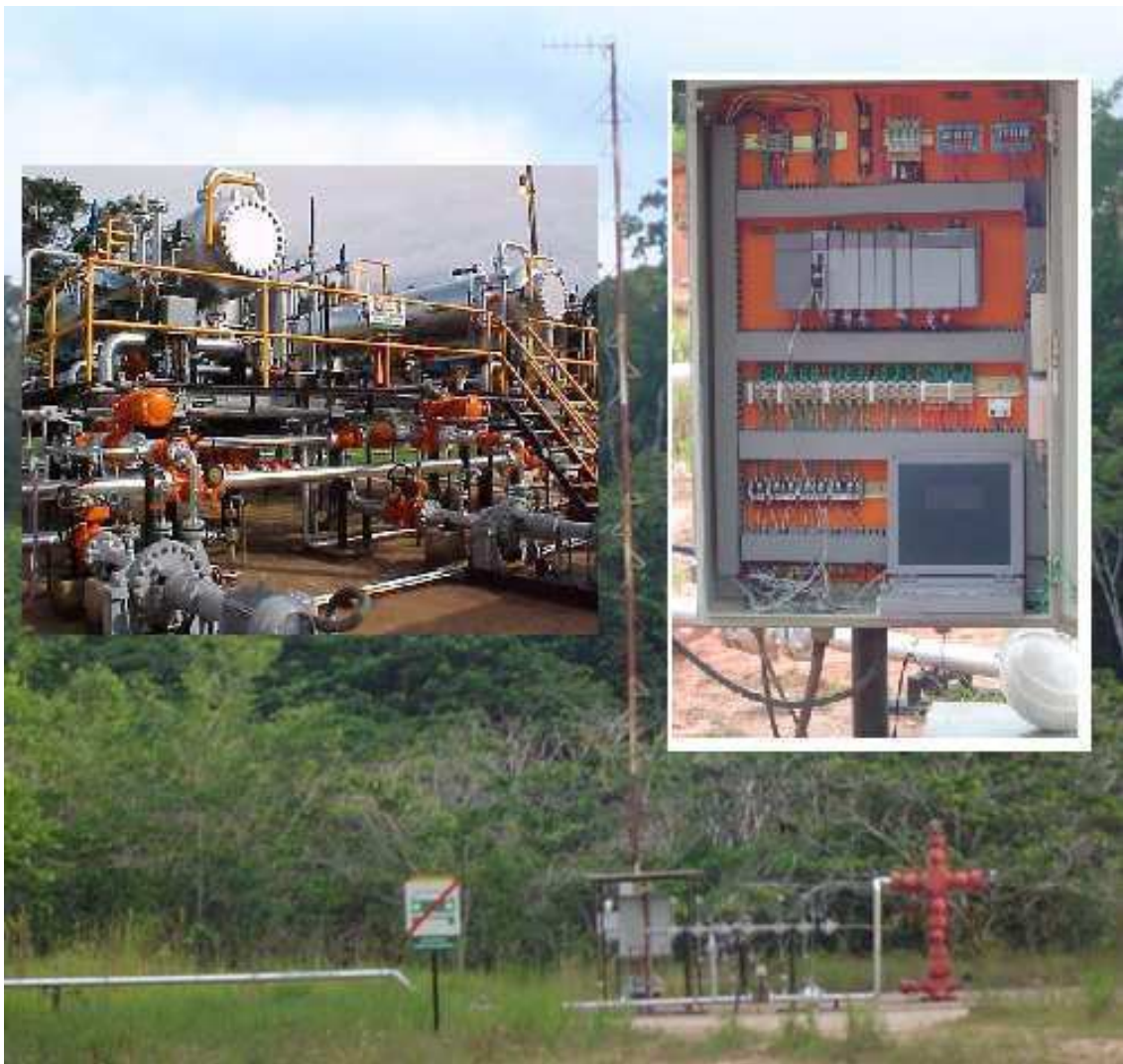
Figura 3.5 – Instrumentação e Automação de poços e separadores de Urucu
