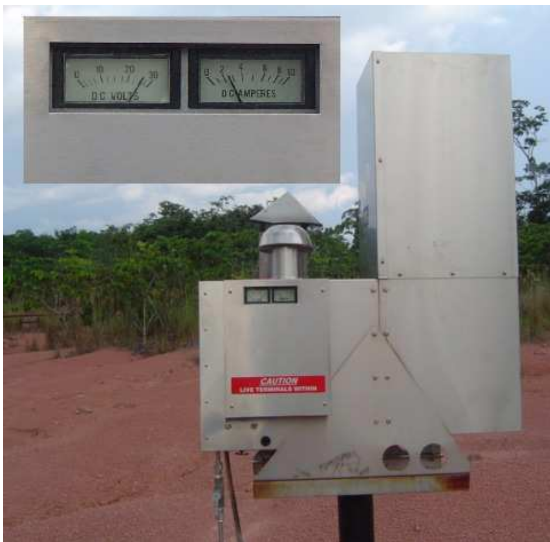
Figura 3.4 – Gerador termoelétrico da Unidade Terminal Remota
