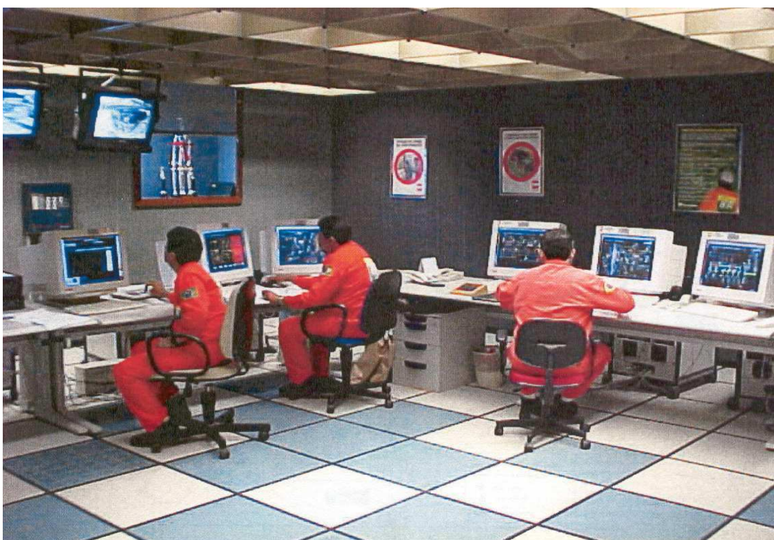
Figura 3.1 – Sala de Controle da Estação do Pólo Arara
