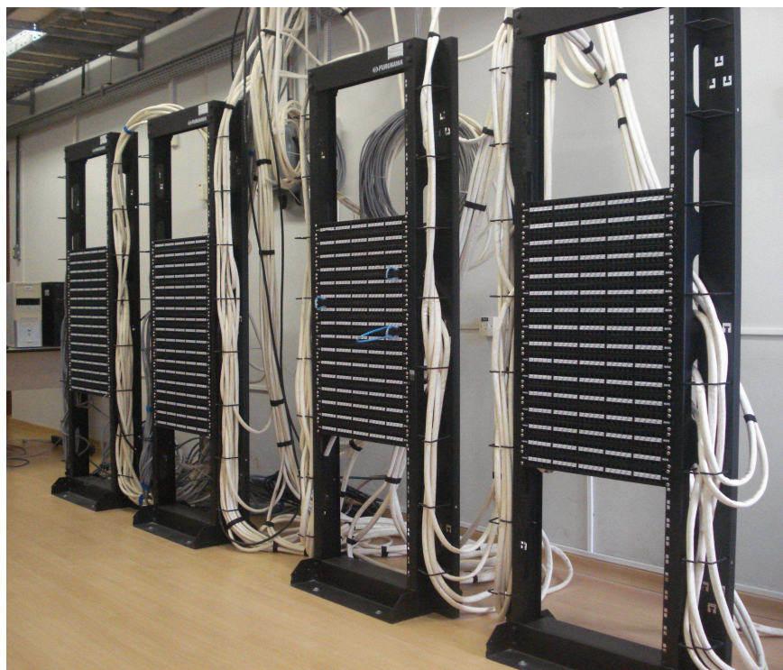
Figura 1: Visão frontal do conjunto de racks com voice panels .
