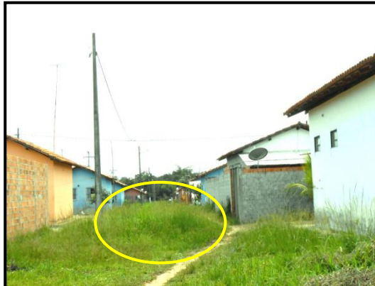
Foto 28. RUA OBSTRUÍDA NO CONJUNTO JARDIM DAS GARÇAS. (Santa Isabel do Pará, FNHIS/PAC/PMCMV). Apesar de construído recentemente, o referido conjunto já apresenta sinais de deterioração semelhantes aos dos conjuntos do PAIH. Fonte: Trabalho de Campo, 2013.
