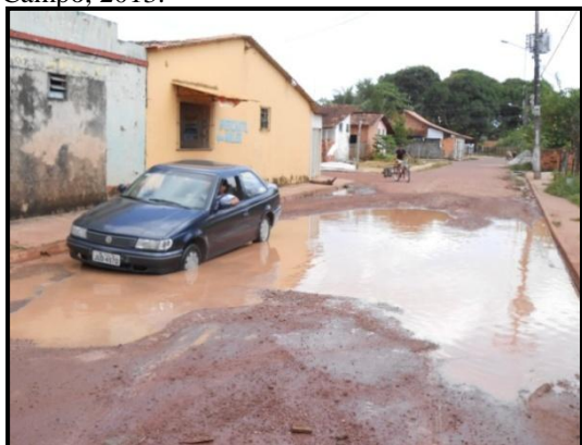
Foto 29. PASSAGEM COMPROMETIDA NO CONJUNTO RAIMUNDO CÉSAR GASPAR. (Santa Isabel do Pará, PAIH). Foto retirada no final da linha do ônibus que interliga Santa Isabel do Pará à Belém. Destaque para os resquícios de pavimentação e para um imenso buraco, dificultando a passagem do automóvel. Fonte: Trabalho de Campo, 2013.
