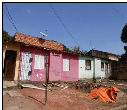
Foto 12. CONJUNTO VERDEJANTES (Ananindeua). Exemplo de tipologia horizontal produzida pelo PAIH. Esse Plano produziu apenas conjuntos horizontais. Na imagem, casas geminadas destinadas aos segmentos de menor renda. Fonte: Trabalho de Campo, 2013.
