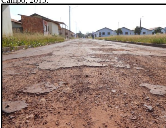
Foto 30. PAVIMENTAÇÃO DETERIORADA NO CONJUNTO JARDIM DAS JURUTIS (Benevides, PMCMV). Trata-se de um conjunto recente oriundo do PMCMV, já apresentando, no entanto, sérios problemas de infra-estrutura, evidenciados no asfalto de péssima qualidade que se deteriora rapidamente. Fonte: Trabalho de Campo, 2013.
