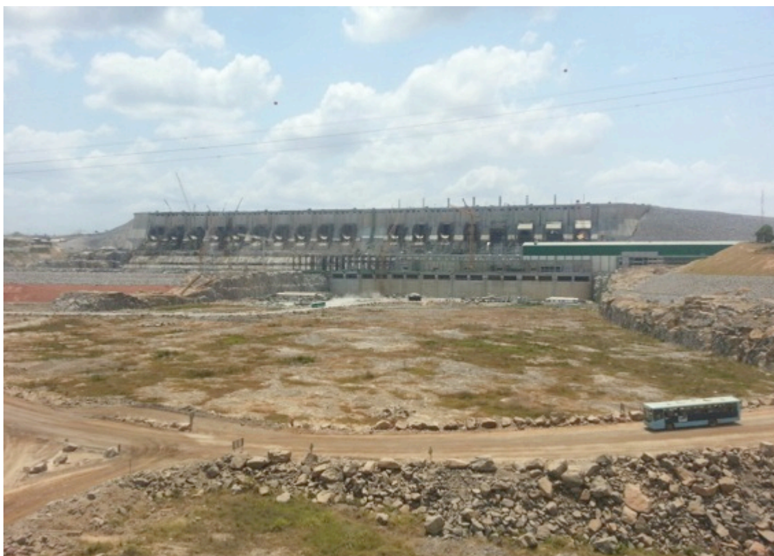
Foto 07: Casa de Força Principal de Belo Monte – Sítio Belo Monte em Vitória do Xingu/PA.
