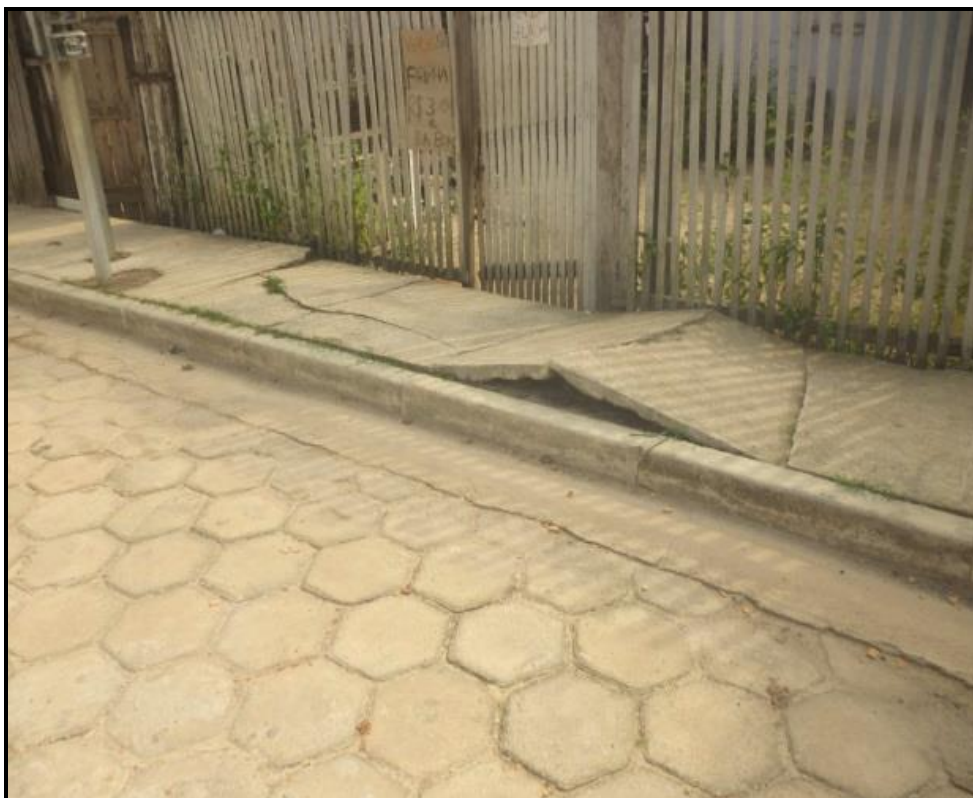
Figura 24: Calçadas quebradas na Comunidade Fé em Deus. Fonte: Odália Borges, 2015.
