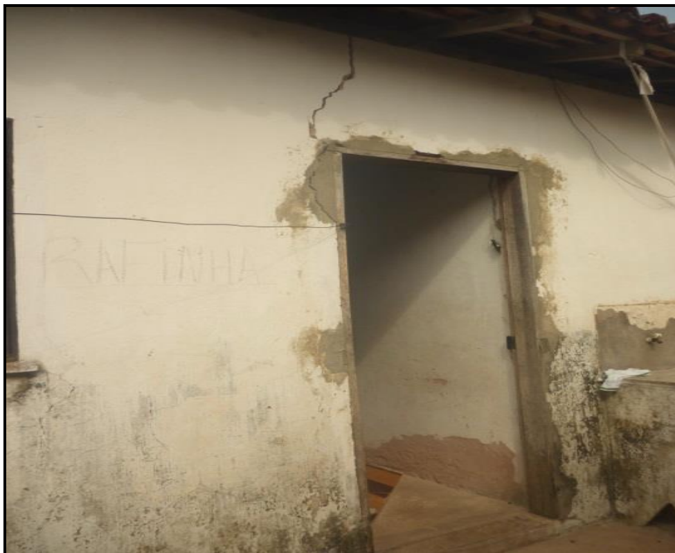
Figura 25: Unidade habitacional com rachaduras. Fonte: Odália Borges, 2015.
