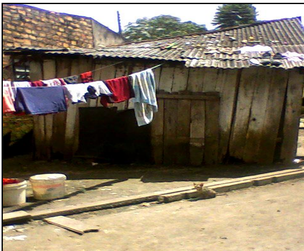
Figura 7: Moradia precária com risco de desabamento. Fonte: BORGES, 2011.
