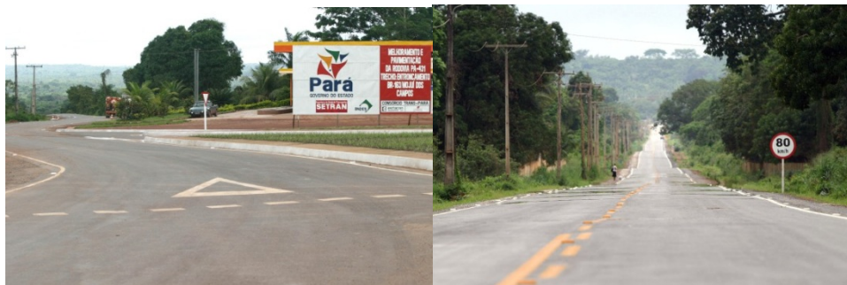
Figura 11 - Melhoramento e Pavimentação da Rodovia PA-431, trecho: Entroncamento BR-163 / Mojuí dos Campos, município de Santarém. (Fonte: www.pa.gov.br )
