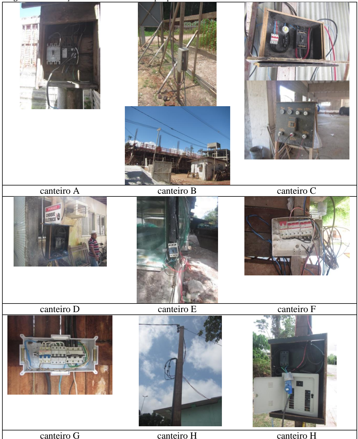
Figura 18 - Instalações elétricas dos canteiros pesquisados
