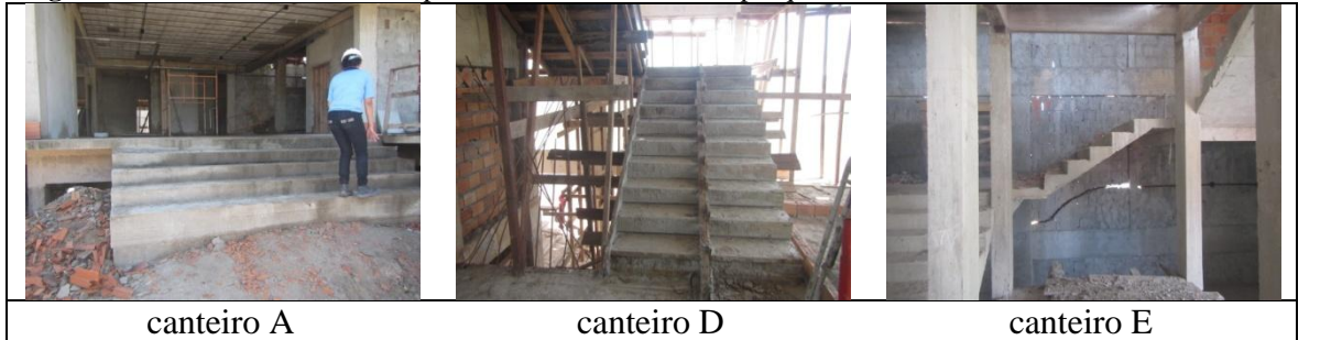
Figura 12- Corrimão das escadas permanentes dos canteiros pesquisados
