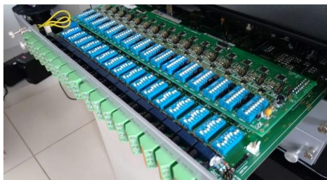
Figura 83 - Placas de Conversão e Comunicação
