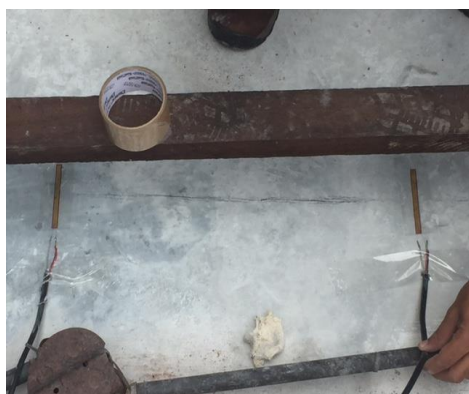
Figura 77 – Gage de 84mm no Concreto
