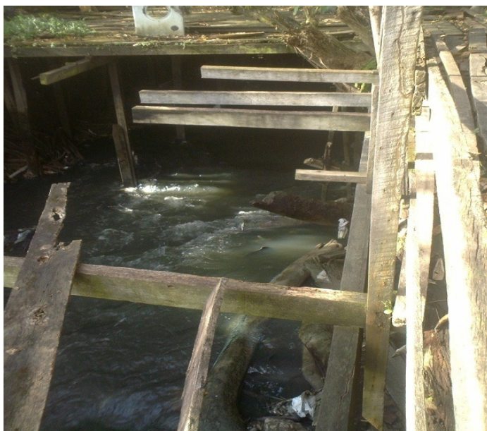
Foto 1. Galeria subterrânea por onde desemboca a água do canal da Estrada Nova.
