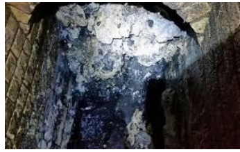
(a) Acúmulo de gordura em esgoto
