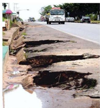
Buracos nas estradas aumentam os riscos de acidentes
