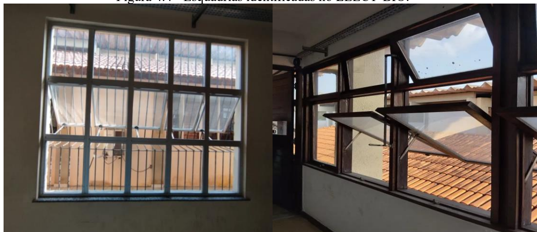
(a) Janela de alumínio com vidro abertura tipo basculantes no corredor térreo do Bloco 1
