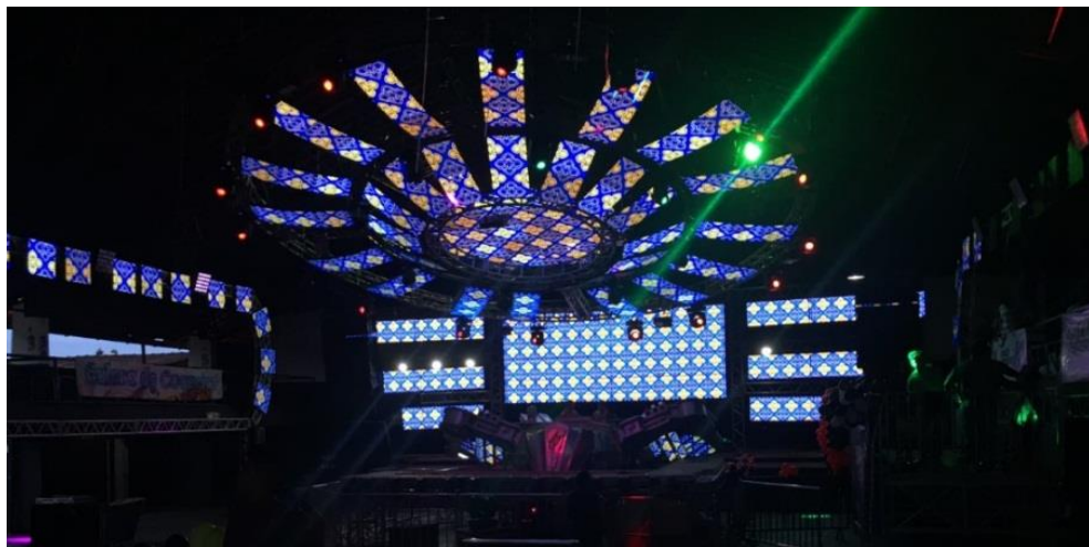
Figura 12 - Aparelhagem montada com 60% de seu equipamento
