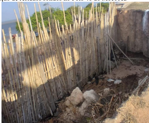
Figura 9 – Erosão e disposição de resíduos sólidos no Polo 40 do Mocooca
