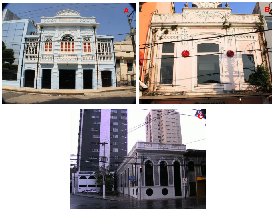
Figura 37: Alteração de vãos e esquadrias: Prédio da Assembleia Legislativa, Cidade Velha (a); Edificação comercial, Tv. Santo Antônio, Comércio (b); Banco Real, Nazaré (c).
