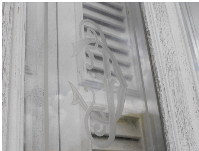
Figura 36: Janela do 2º pavimento da fachada voltada à Passagem Joaquim Nabuco, cuja vidraça remanejada foi instalada de maneira invertida.
