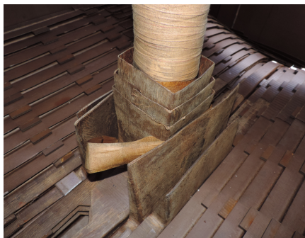
(a) Local do defeito - suspeita.
