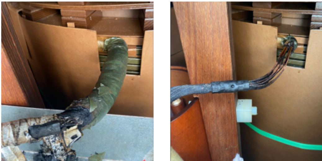
Figura 32 – Conexão frouxa - fonte de aquecimento.
