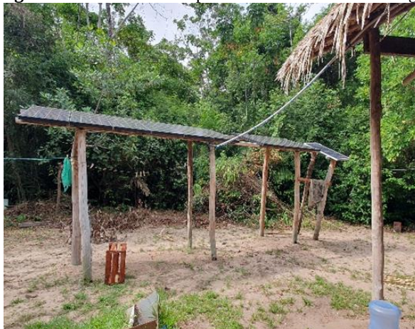
Figura 7 – Placas solares para o fornecimento de energia
