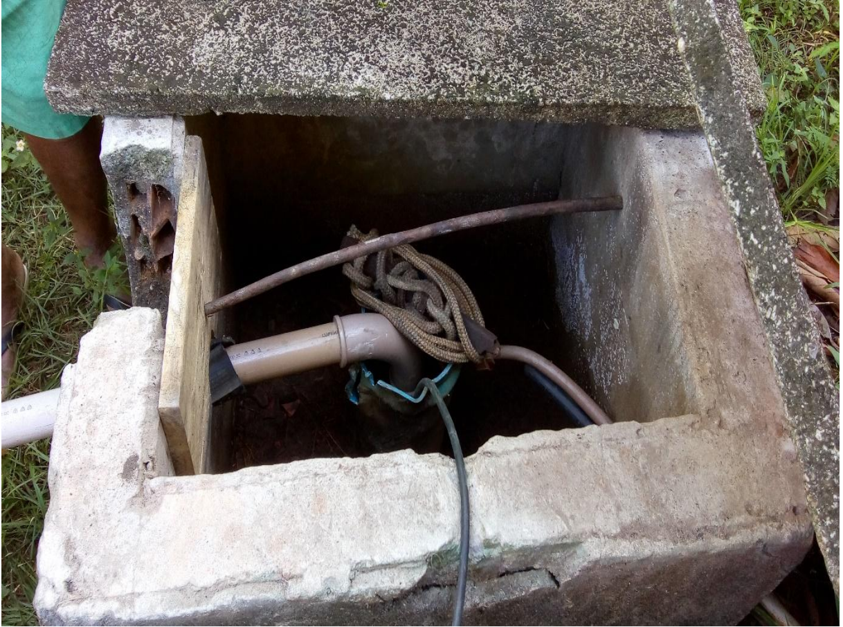
Figura 23– Poço para abastecimento da comunidade Candeúba.
