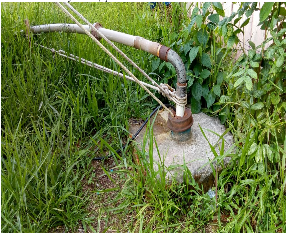
Figura 20– Poço para abastecimento da comunidade Jancolândia.
