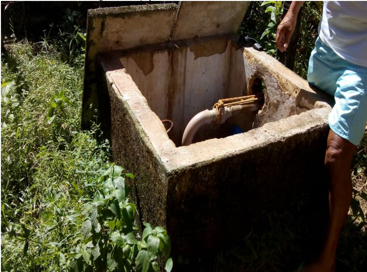
Figura 25– Poço para abastecimento da comunidade Ariri.
