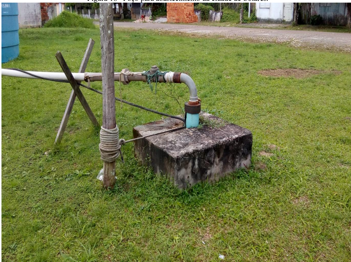
Figura 18– Poço para abastecimento da cidade de Colares.
