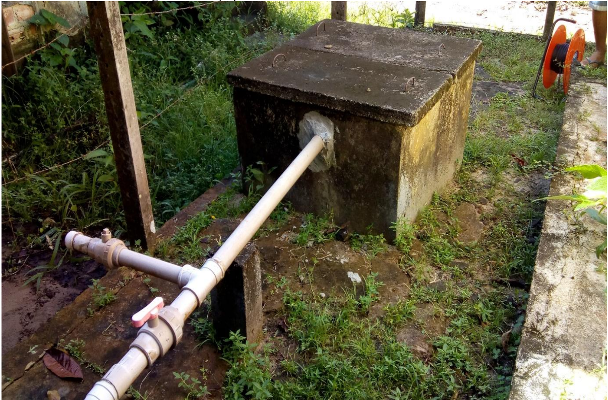
Figura 21– Poço para abastecimento da comunidade Fazenda.
