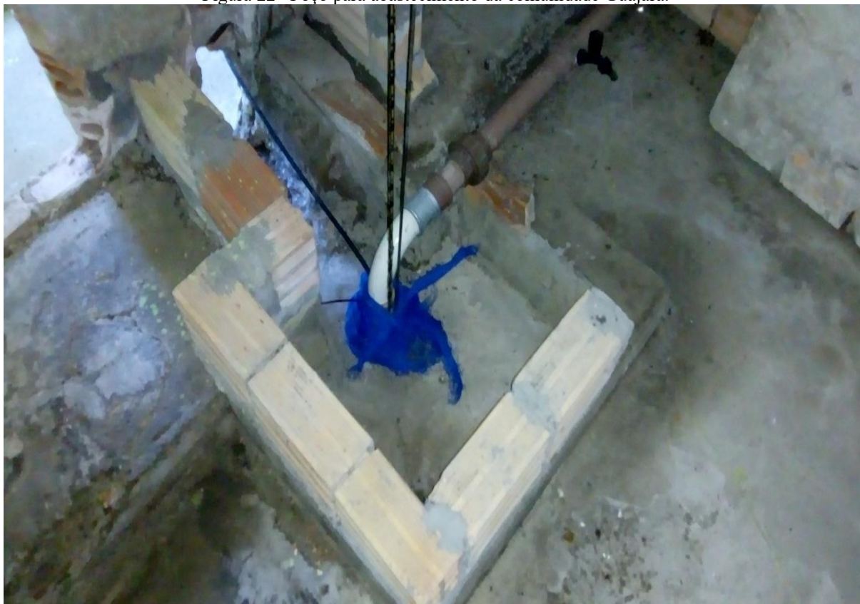
Figura 22– Poço para abastecimento da comunidade Guajará.
