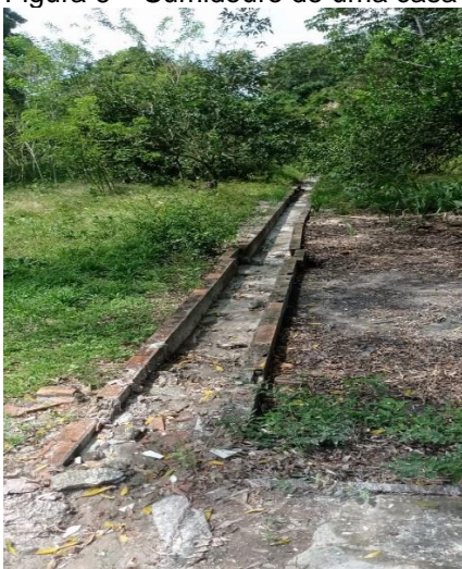
Figura 6 – Sumidouro de uma casa de farinha com registro na ADEPARÁ
