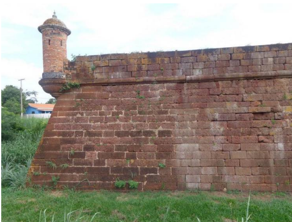
Fig.21. Muralha da face norte do Baluarte de Santo Antônio de Pádua onde se observam as linhas claras de blocos de crostas lateríticas que chegam a 17 fiadas (as da base parcialmente encobertas pela vegetação e solo), interceptada pela linha do cordão seguida de mureta com 4 fiadas. Os blocos são contrafiados e apresentam dimensões variadas, contudo a altura é regular com cerca de 32cm.
