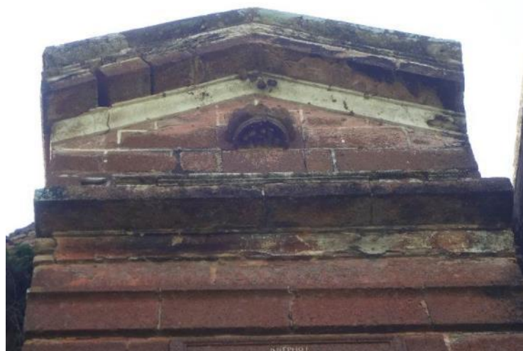
Fig. 37. Arremate do frontão triangular segmentado no acesso ao RFPB, com indícios de uso de tijoleiras e rochas, aplicação de argamassa de reboco e pintura imitativa de blocos de pedra, similar ao trabalho observado nas guaritas dos baluartes de N. Srª da Conceição e de Santo André Avelino.
