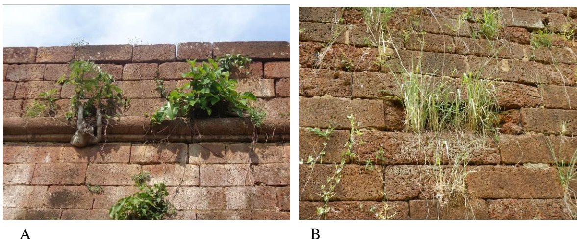
Fig. 44. (A) Face oeste do baluarte de N. Srª da Conceição, onde vegetação aérea com raízes impregnadas nas muralhas desagregam os blocos entre as frestas apenas preenchidas com argamassas de ligação. (B) Clara visualização e distinção do comportamento dos blocos de rochas lateríticas nas muralhas, sendo as crostas cavernosas e as mais próximas do mosqueado mais suscetíveis ao intemperismo biológico. Foto: RN, 2015 (A); MLC, 2015 (B).
