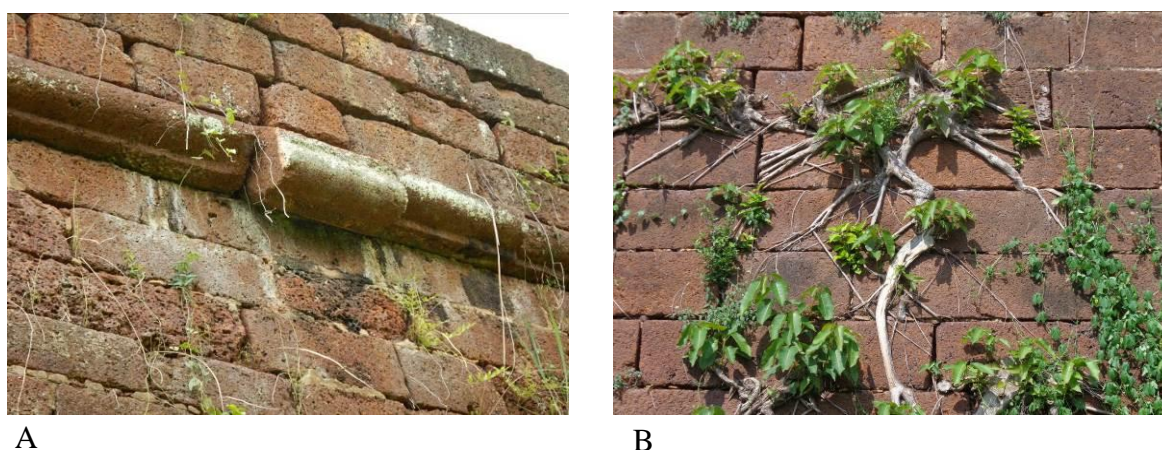
Fig. 22. (A) Deslocamento de bloco que compõe o cordão da muralha e desagregação da linha de blocos da mureta do terra pleno com risco de desabamento, além de marcas de lixiviação e biodeterioração ocasionadas por fungos, algas, líquens e vegetação. (B) Degradação ocasionada por vegetação com enraizamento profundo nas muralhas e alto risco de desagregação entre blocos.
