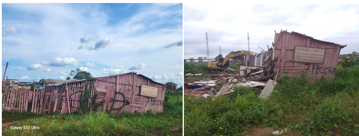
Figura 11: Casa dentro da lagoa/ aguardando ser indenizada
