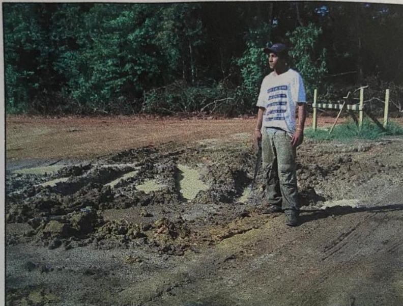
A estrada, com a passagem diária das máquinas, encontra-se em péssimas condições, os carros de viagem não passam, a bicicleta em alguns locais tem que ser carregada, e quem vai a pé leva várias quedas no caminho.
