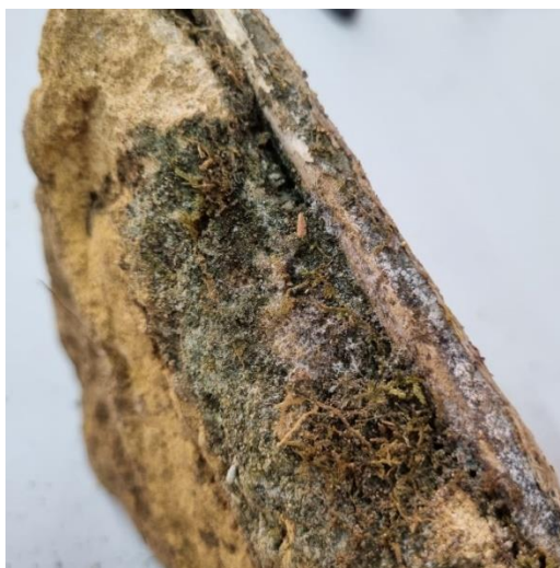
Figura 6 – Presença de musgos indica estágio avançado de biodeterioração.
