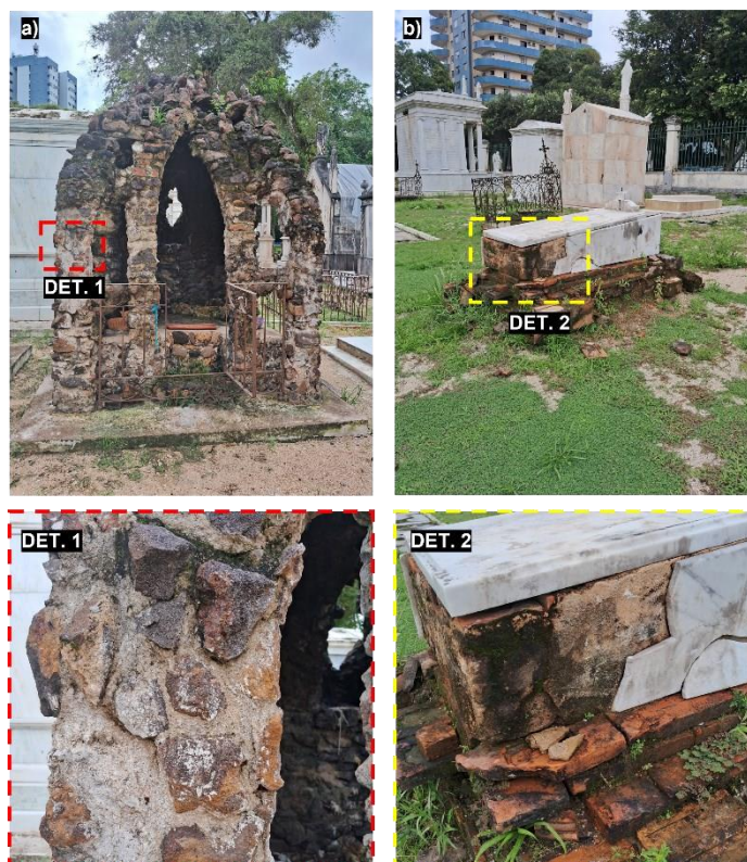
Figura 1: Aplicação das argamassas em diferentes sistemas construtivos: a) argamassas de assentamento em alvenaria de pedra/tijolo e argamassas de embasamento (base) do mausoléu; DET. 1 - detalhe da argamassa de assentamento ligando os arenitos ferruginizados; b) túmulo em alvenaria e embasamento de tijolos, e alicerce em arenito ferruginizado. DET. 2 - detalhe das placas de mármore revestindo a sepultura.
