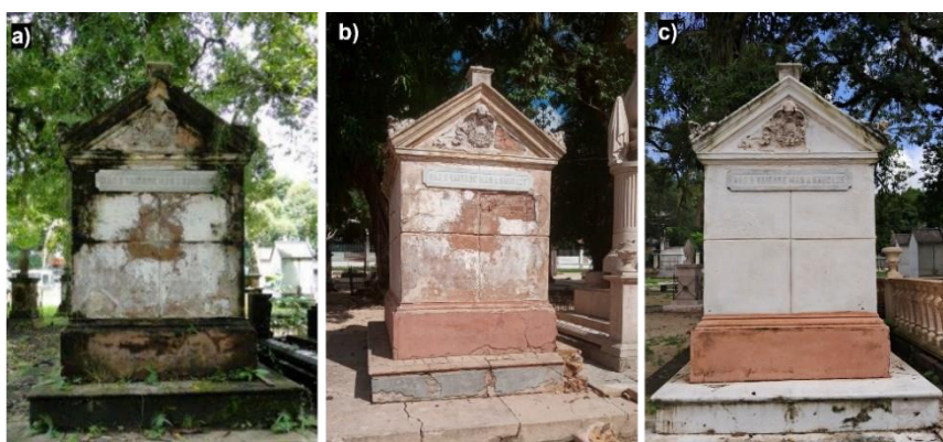
Figura 6: Registro do estado de conservação e passagem do tempo do exemplar C7 que contém argamassa pigmentada: a) imagem registrada em 2013 mostra o mausoléu em péssimo estado de conservação, onde se é difícil identificar a argamassa pigmentada. Fonte: LACORE, 2013; b) Mausoléu após limpeza realizada no projeto de restauro do Soledade em 2022; c) Mausoléu após o processo completo de intervenções de conservação e restauração em que novas argamassas pigmentadas foram aplicadas. Imagem registra em 2024.
