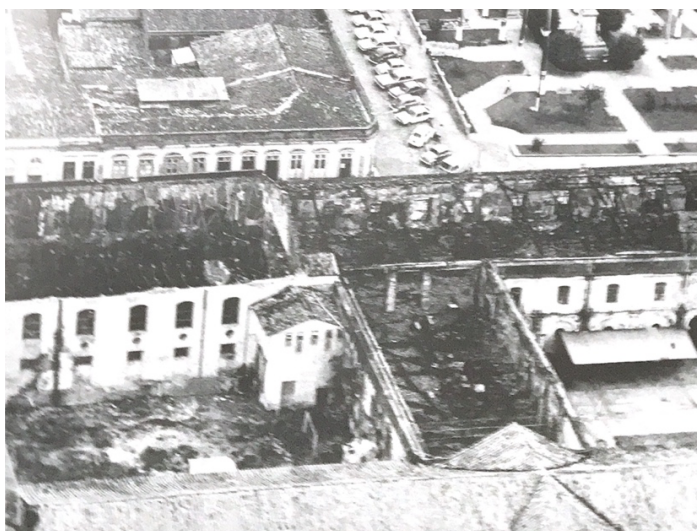
Figura 20: Condições em que se encontrava o prédio pós incêndio, com a destruição total da cobertura. As edículas existentes no pátio são resultantes de sucessivas adaptações que agrediam a arquitetura do monumento. Fonte: Ferraz, 2000.
