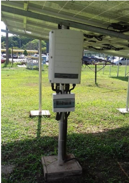
Figura 3.31 – Inversor e quadro de disjuntores.
