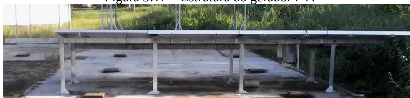
Figura 3.17 – Estrutura do gerador FV.
