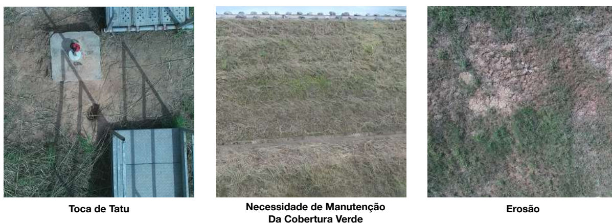
Figura 17 – Exemplos de anomalias encontradas durante visitas técnicas.
