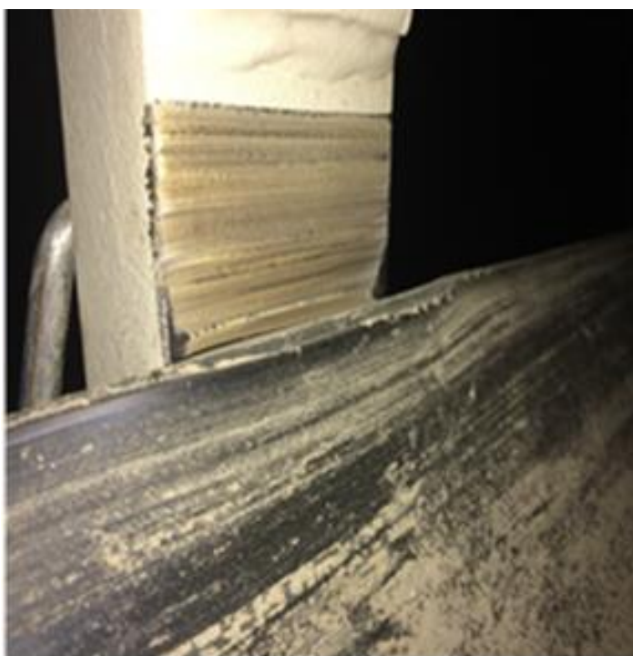
Figura 2.14 - Desgaste da estrutura do transportador. Fonte: Nortnowski et al. , 2022.
