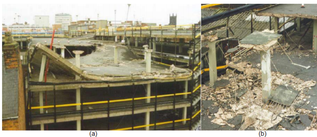
Figura 2.2 - Acidente no edifício Pipers Row Car Park, em Wolverhampton. Fonte: WOOD (2003)
