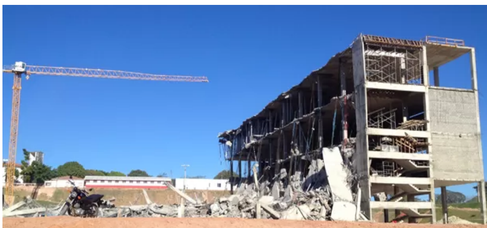
Figura 2.3 - Acidente estrutural no shopping Rio Poty, em Teresina – PI. Fonte: CREA – PI (2013)
