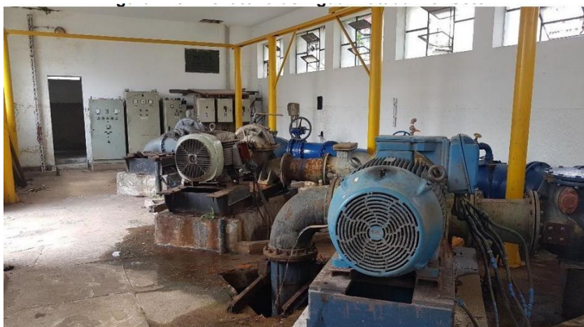
Figura 8 - Elevatória de Água Tratada – 3º Setor
