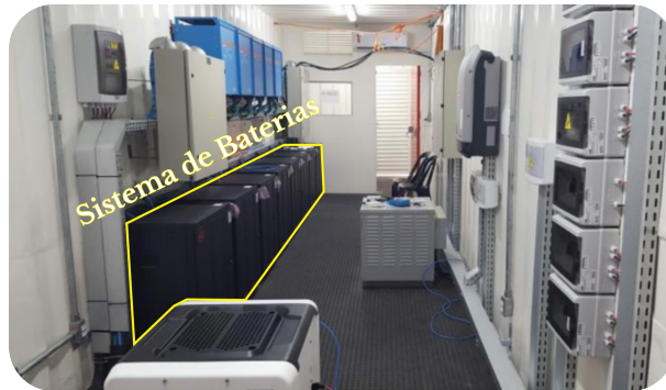
Figura 44 – Eletrocentro com o Sistema de Baterias em destaque
