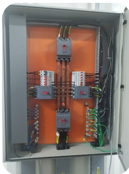
Figura 65 – Quadro de energia que disponibiliza as informações ao UACT 3F
