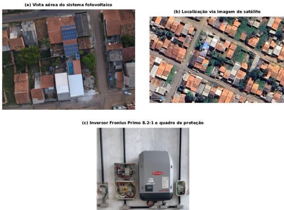
Figura 8 – Sistema fotovoltaico em estudo: (a) vista aérea da instalação, (b) localização por imagem de satélite e (c) inversor e quadro de proteção.
