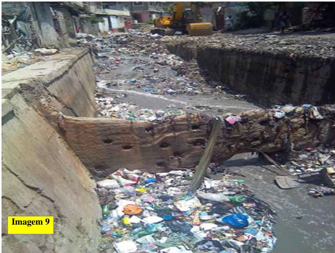
Imagens 9 e 10. Degradação das áreas de captação
