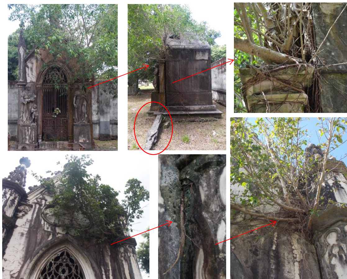
Figura 66: Mausoléus sofrendo a ação de plantas superiores, cujas raízes penetraram as estruturas.
