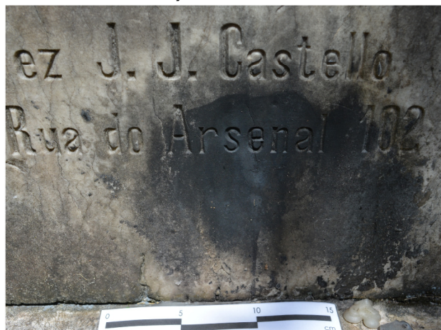
1- CARBONIZAÇÃO/ DEPÓSITO DE CERA
