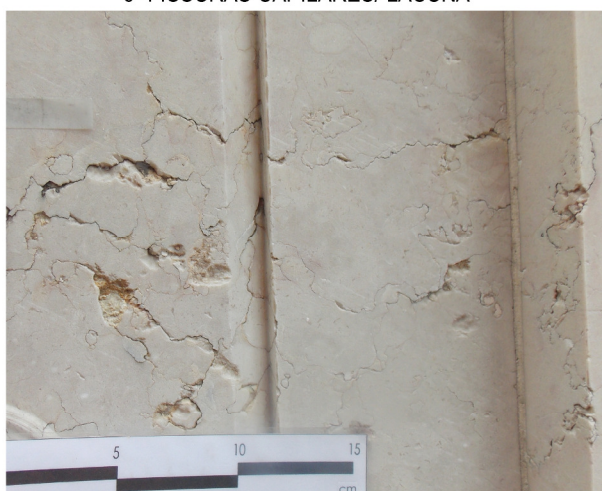
6- FISSURAS CAPILARES/ LACUNA
