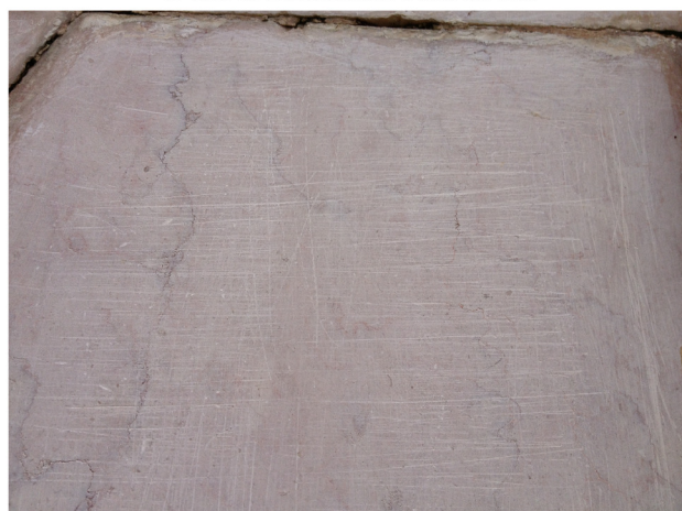
3- DANO MECÂNICO- ARRANHÃO
