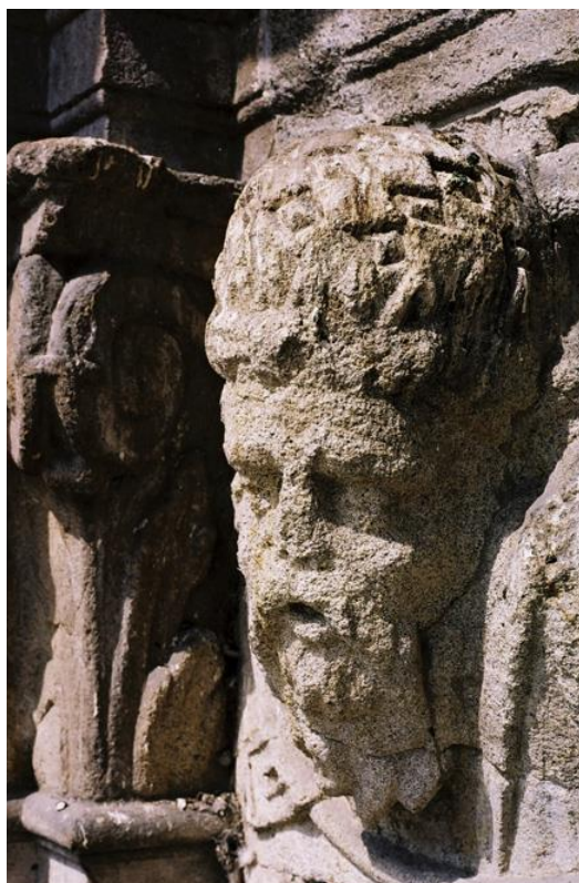
Figura 03: Desagregação granular em granito. Fonte: BEGONHA, 2009.
