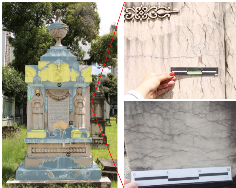
Figura 69: Mapeamento de danos no túmulo B09 com marcação em amarelo de danos do grupo fissura e deformação e microfissuramentos em destaque.
