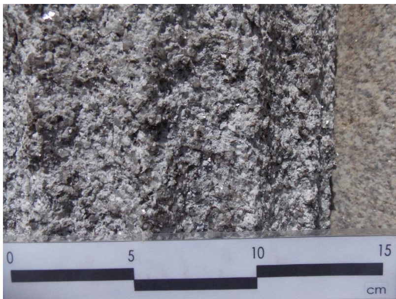
Figura 73: Desagregação granular no granito.
