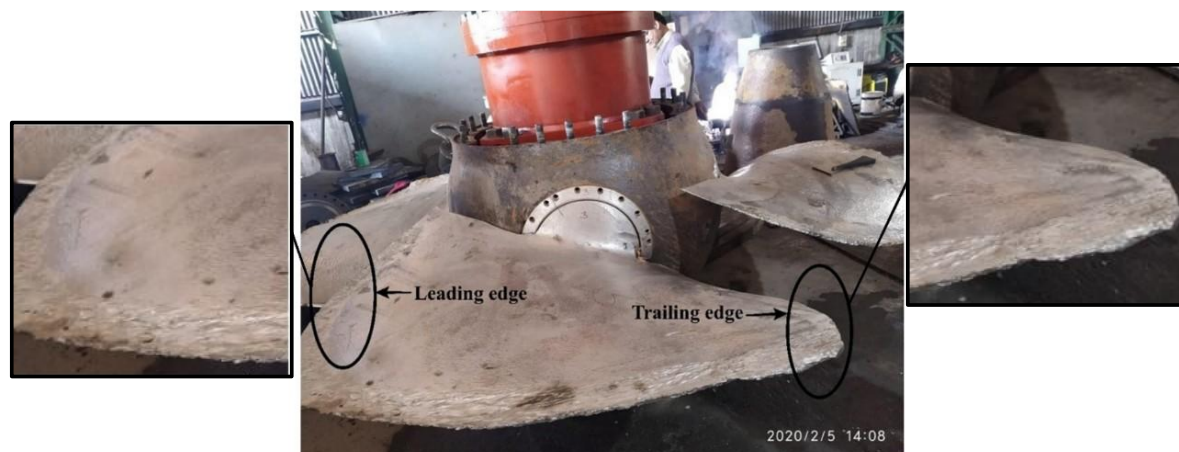
Figura 3.4 – Turbina Kaplan com efeitos de erosão nas pás do rotor. Fonte: Adaptado Arora, Kumar e Singal, (2024).
