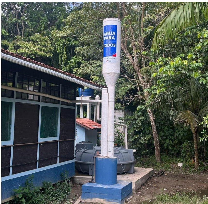
Figura 38 - Estação de tratamento programa “Água Para Todos”.
