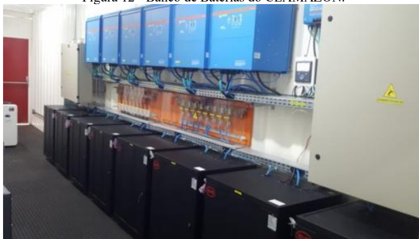
Figura 12 - Banco de Baterias do CEAMAZON.
