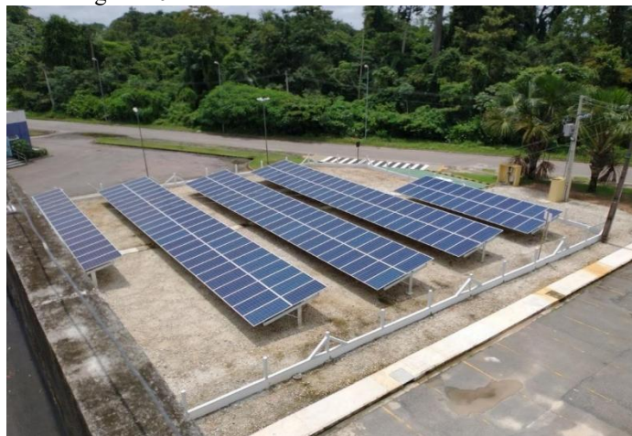
Figura 10 - Painéis Fotovoltaicos do CEAMAZON
